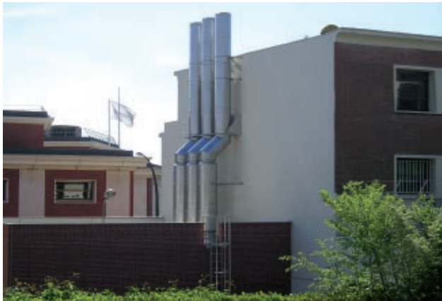
Abb. 89: Edelstahlabgassysteme bei verbrennungsmotorisch betriebenen Feuerungsanlagen
