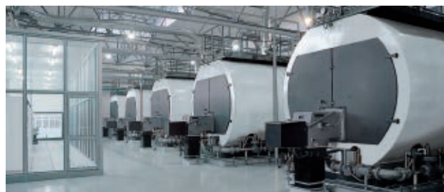
Abb. 107: Fünf gasbetriebene Hochdruckdampferzeuger für jeweils 16 Tonnen Dampf pro Stunde und 10 Bar Betriebsdruck
