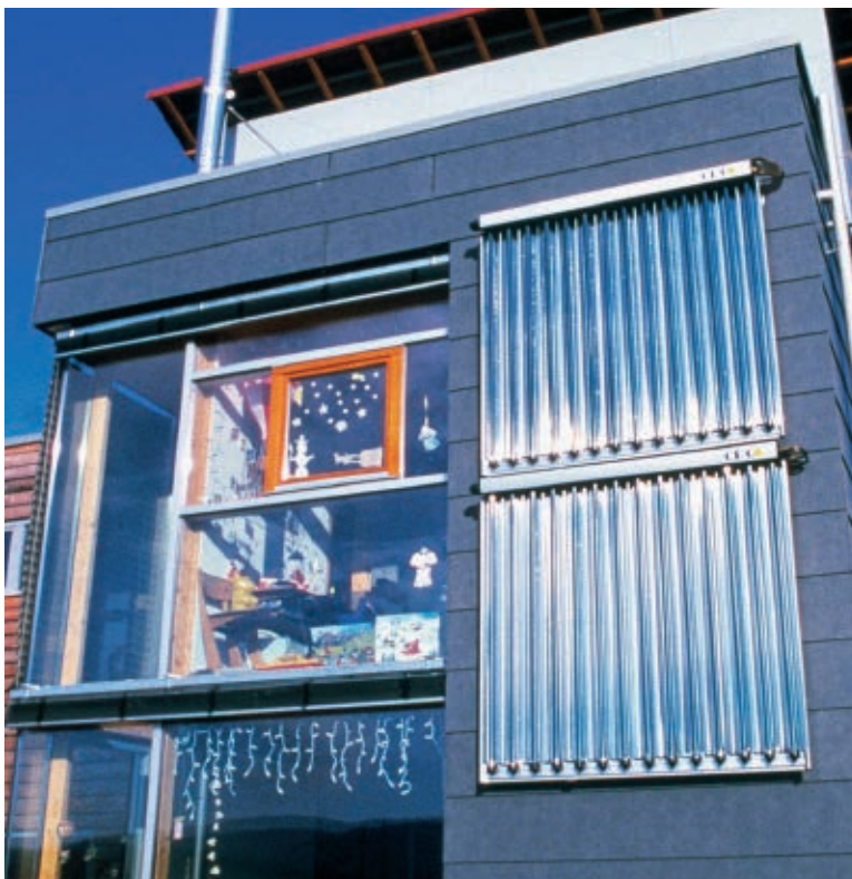
Abb. 46: Praxisbeispiel für die Anwendung von Solarthermie-Vakuümrohrenkollektoren
