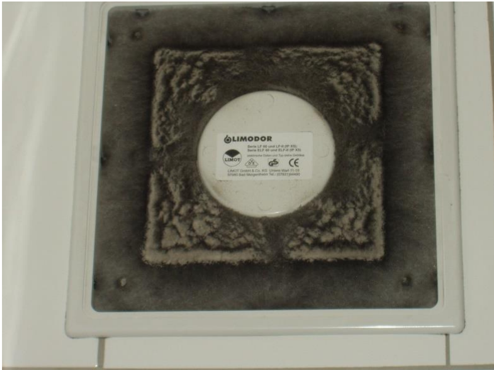
Foto: Verschmutzter Filter bei Abluftanlage, Quelle wird noch ergänzt
