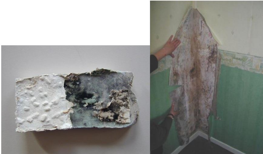
Fotos verdeckte Schäden (Quelle: Lorenz)
